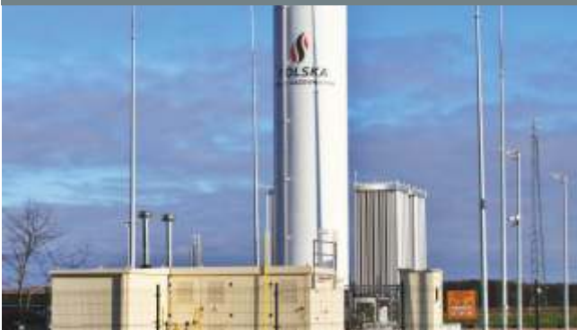
Stacja regazyfikacji - 10 000 000 zł
